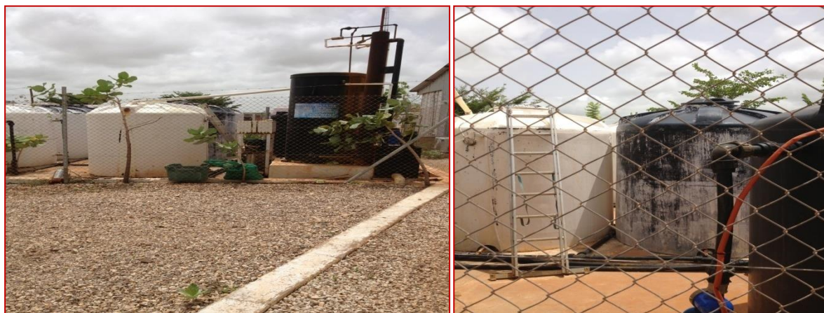
Photo II-3 : Station de potabilisation de l'eau
