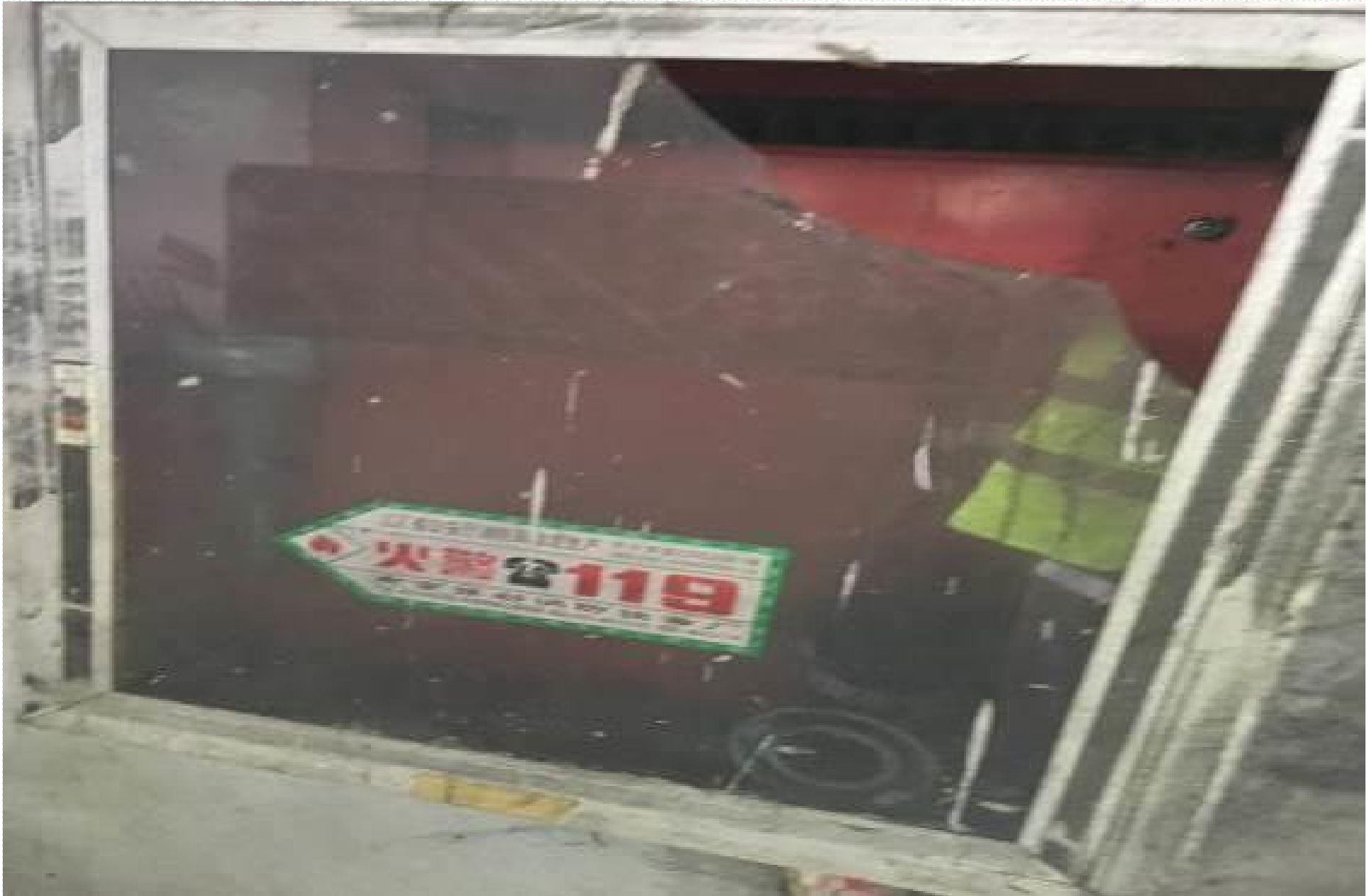
Robinets d'Incendie Armés (RIA) non opérationnels posant le problème de la gestion de potentiels incendies
