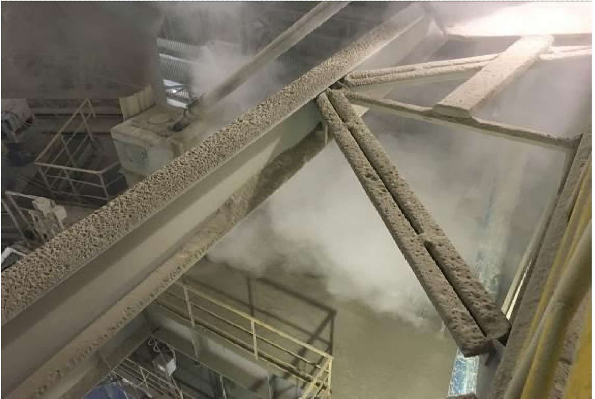
Défaut d'étanchéité de certaines installations (forte échappée de poussières)
