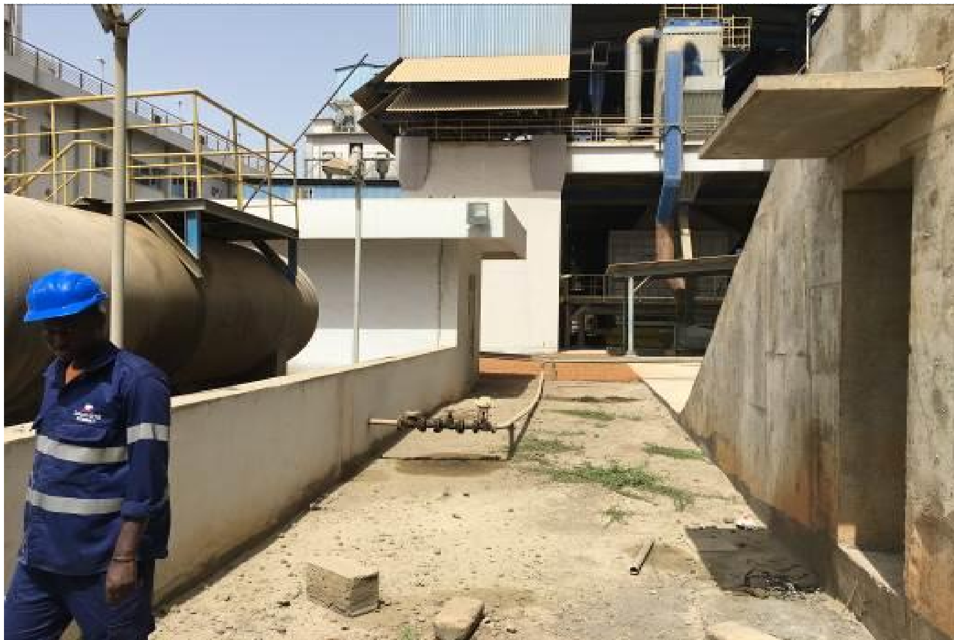
fuite d'hydrocarbures à partir de la vanne d'alimentation des auxiliaires
