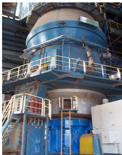
Photo 4 : Broyeur à ciment
