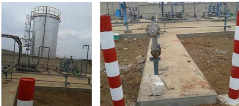
Photo 8 : Stockage d'hydrocarbure et zone de dépotage
