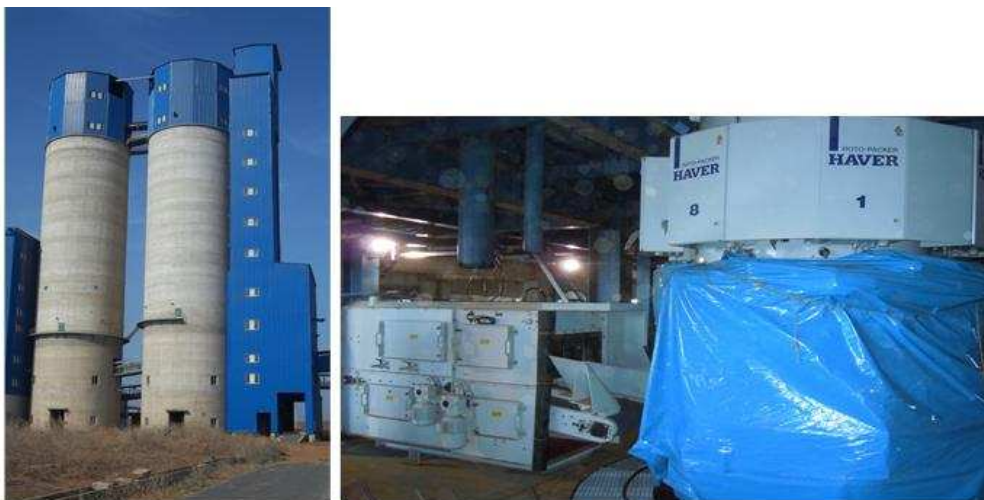
Photo 5 : Silos de stockage du ciment (à gauche) et Ensacheuses de ciment (à droite)
