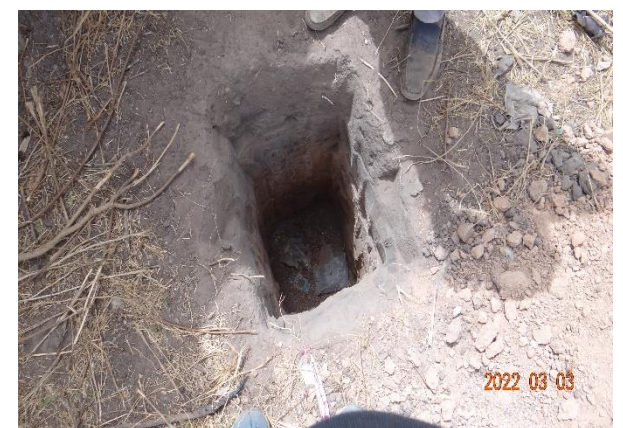
Photo 9 : Trou creusé pour l'implantation des poteaux et non remblayé (Risque d'accident)
