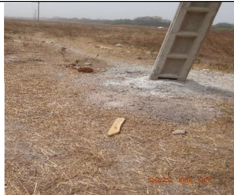
Photo 22 : Bois d'emballage avec des clous abandonnés sur le chantier
