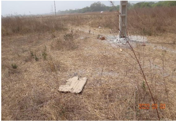
Photo 19 : Déchets de chantier éparpillés dans la zone des travaux
