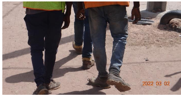
Photo 5 : Personnel de l'Entreprise sans chaussure de sécurité
