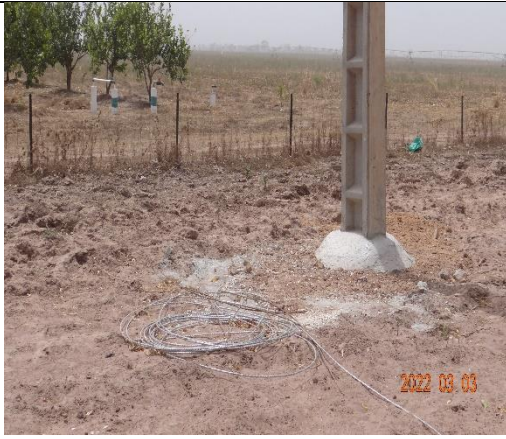
Photo 26 : Déchets de chantier éparpillés dans la zone des travaux
