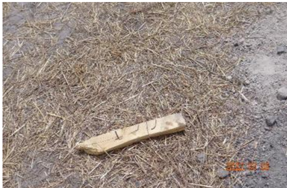
Photo 21 : Bois d'emballage avec des clous abandonnés sur le chantier
