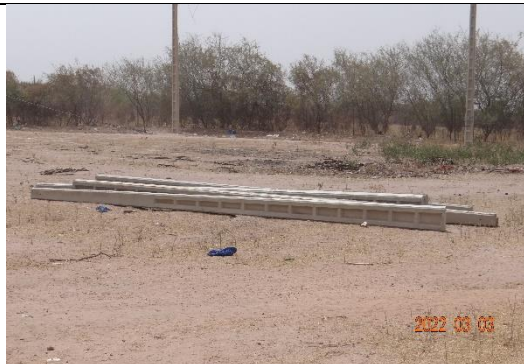
Photo 15 : Poteaux éparpillés sur le chantier
